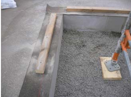
Monterad styrsvyll, synligt mögel
