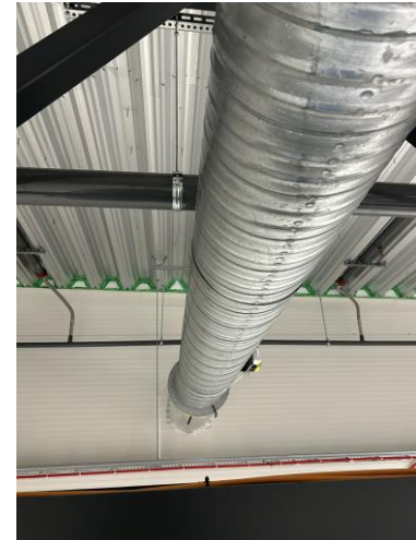
Frånluftskanal (kall luft från flexlager)
