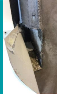
Fogmassa mellan uppvik av fönsterbleck och betongsmyg.
