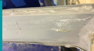
Punktvis med fogmassa på fönsterbleckets bakkant.
