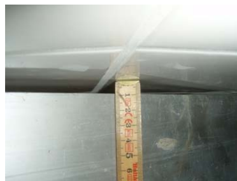
Buktning i våtrumsvägg
